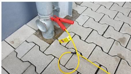
Mise à la terre au niveau du tuyau de descente
