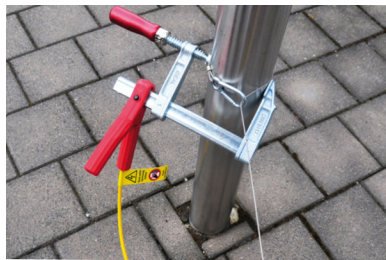
Erdung am Mast mit Hilfe einer Schraubzwinge
