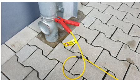
Erdung am Fallrohr
