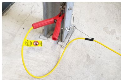
Erdung am Fundamenteerder
